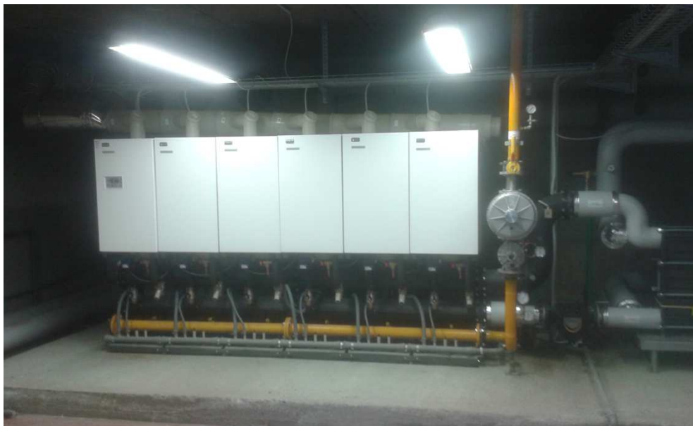
Nuove caldaie installate nella centrale termica del complesso scolastico "L. da Vinci"
