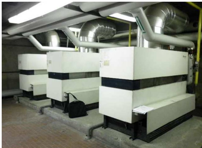
Vecchie caldaie installate nella centrale termica del complesso scolastico "L. da Vinci"
