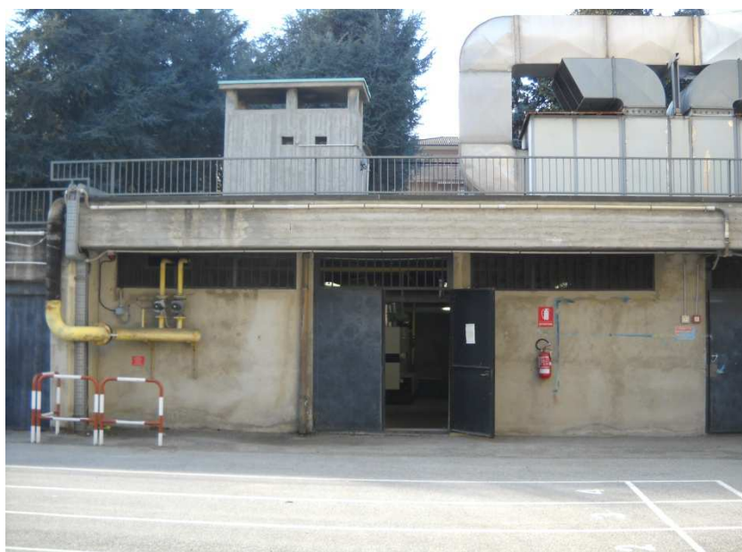
Ingresso della nuova centrale termica del complesso scolastico "L. da Vinci"
